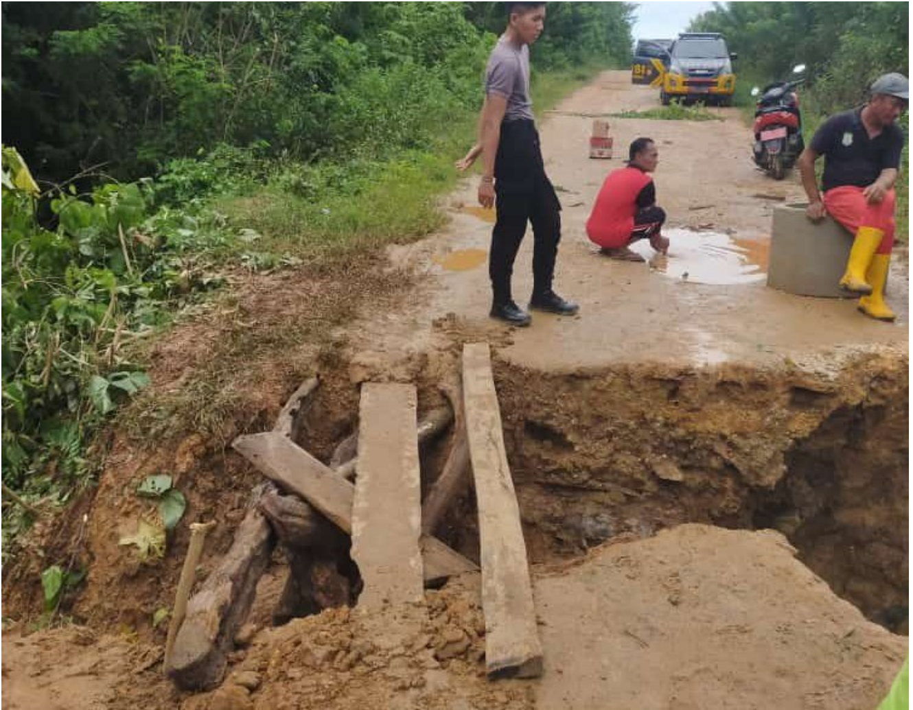
Kondisi jalan terputus di Desa Wumbubangka
